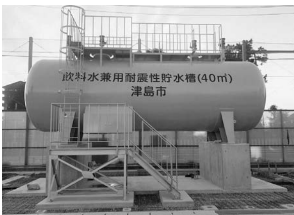
▲耐震性貯水槽(蛭間小学校)
