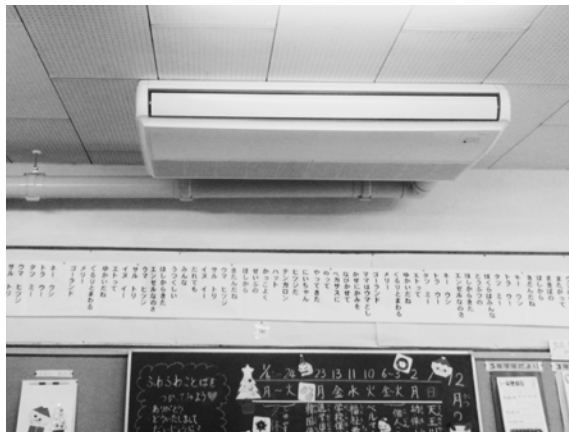
▲エアコン(高台寺小学校)
